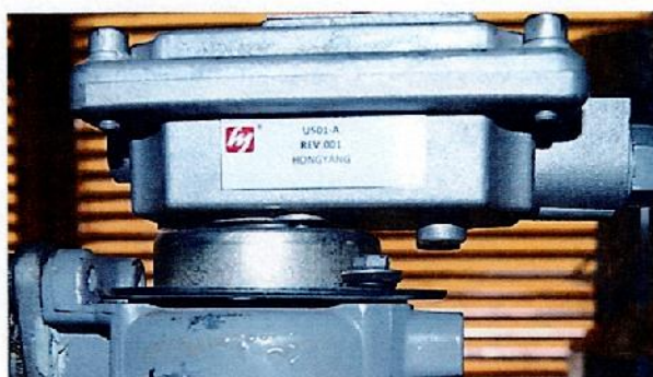
Figura 86. Detalle del acoplamiento del Pulsador al elemento primario de medición U101-B para alto flujo.
